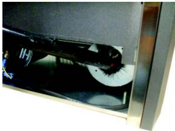
Fig. 56 - Limpieza ventilador ambiente
